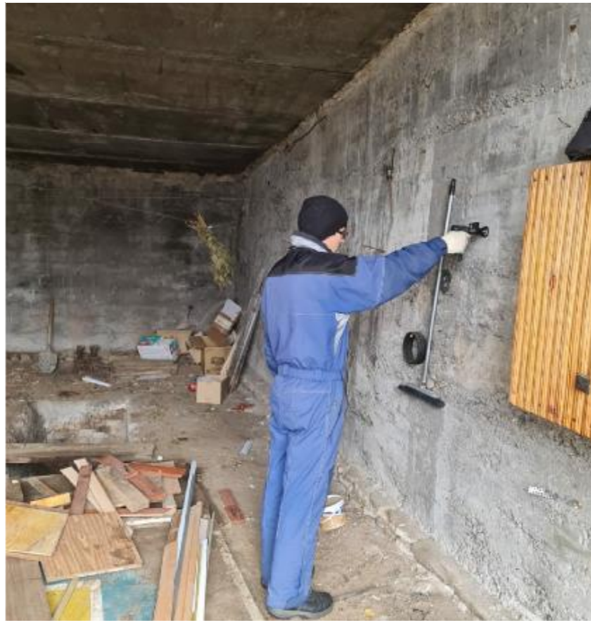
Определение прочности внутренней стены из шлакобетона (№1)
