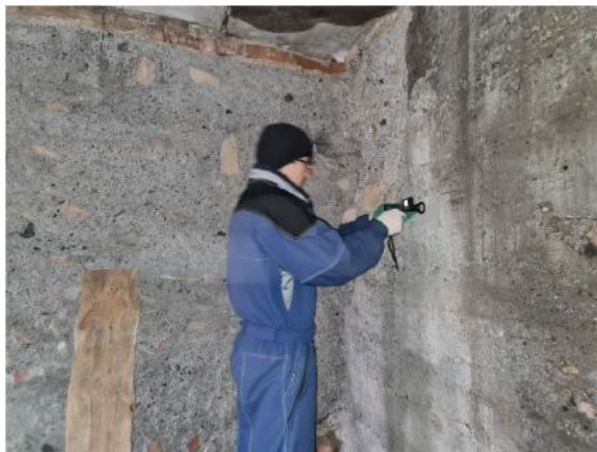
Определение прочности внутренней стены из шлакобетона (№2)
